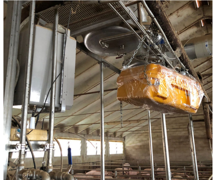
Fig 1. Scrubber a umido e centralina
