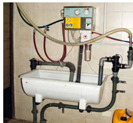
Foto 1 - Vasca di lavaggio con lavatrice automatica con precarica dei volumi utilizzati
